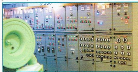
Les armoires électriques.
